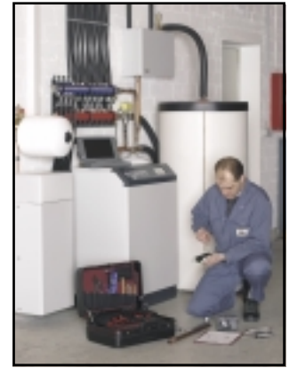
Wärmepumpentechnik ersetzt Feuerungstechnik.
